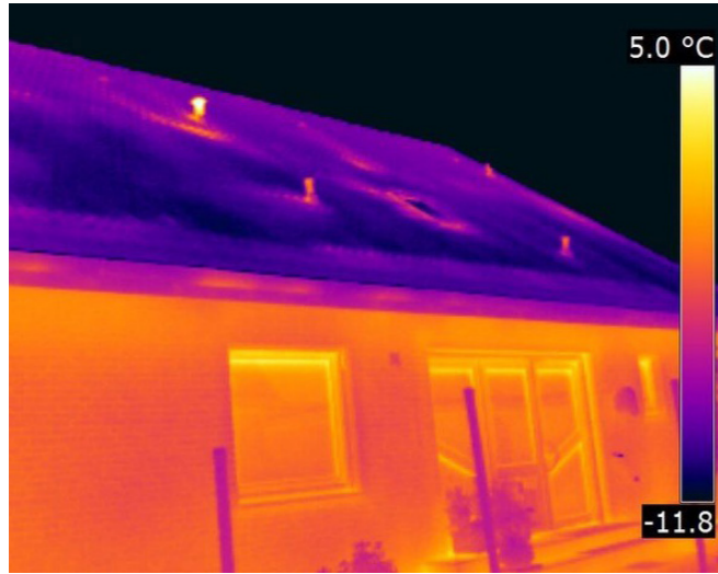
Luftundichtigkeit beim Dach
