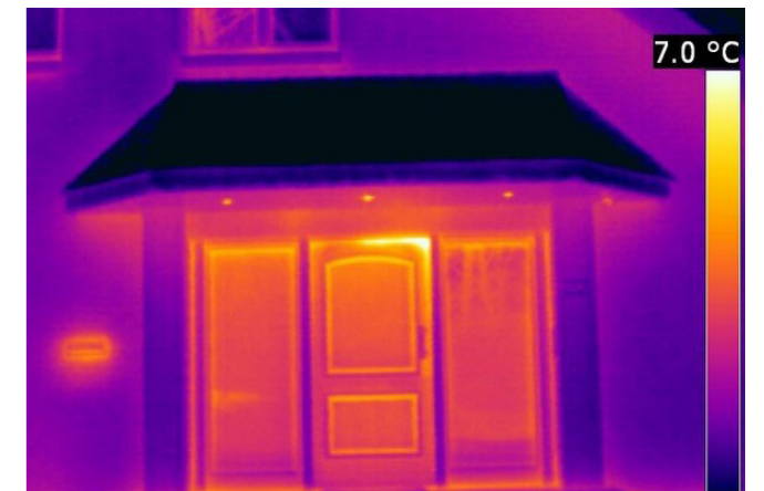
Nicht dicht schließende Haustür
